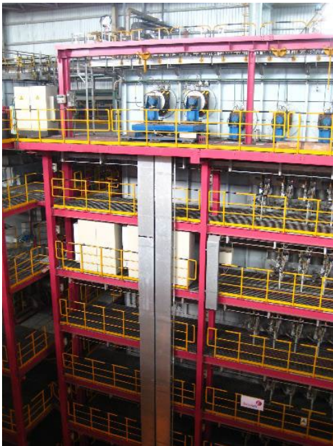
Teilansicht eines Vertikalofens in einer Kontiglhe mit Steuerrollen-Kompensatoren im oberen Bereich. Bild: ©Frenzelit GmbH
