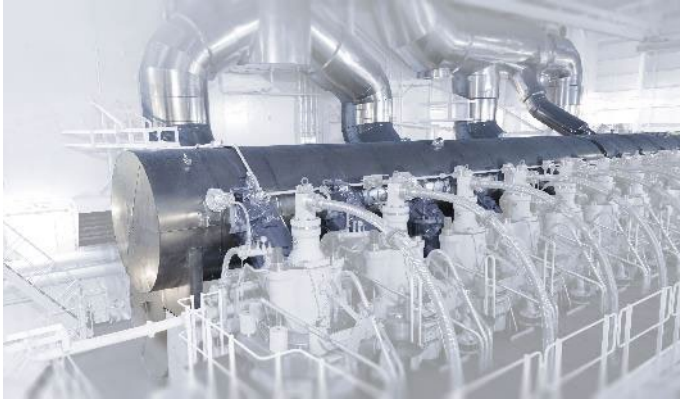
Bild 2: Konventionelle Einhausung der Abgasleitung im Maschinenraum – oft beinhalten diese Einhausungen Isolierkissen, die aber nur bedingt mechanisch belastbar und anpassbar sind. Die Folge sind Hohlräume und eine ungleichmäßige thermische Isolation.
