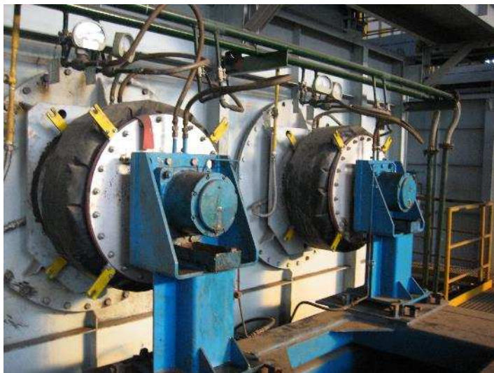
Gewebekompensatoren gleichen die Bewegungen der Steuerrollen aus, die die Blechbänder zentrisch durch den Ofen lenken sollen. Bild: ©Frenzelit GmbH
