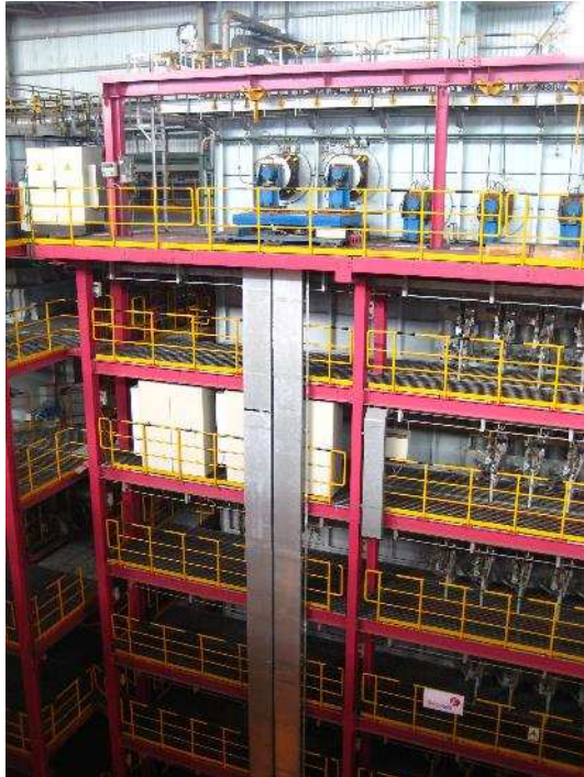
Teilansicht eines Vertikalofens in einer Kontinglühne mit Steuerrollen-Kompensatoren im oberen Bereich. Bild: ©Frenzelit GmbH
