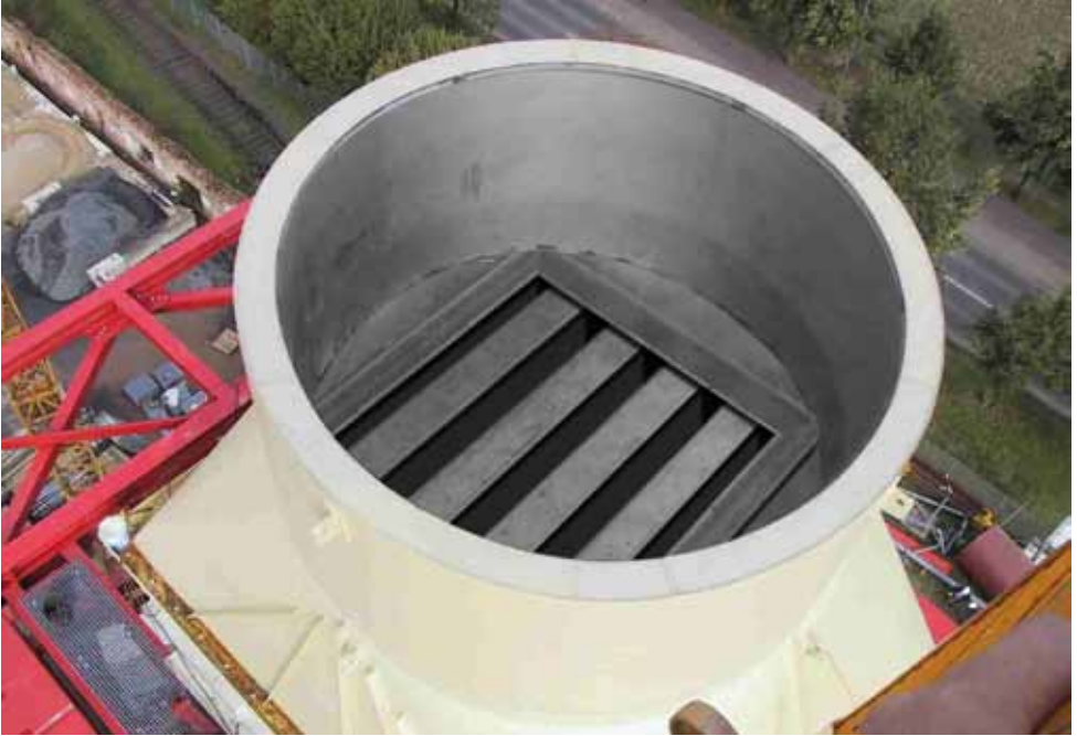
Gut zu sehen, schlecht zu hören: Akustikkulissen im Gasturbinenkamin.
